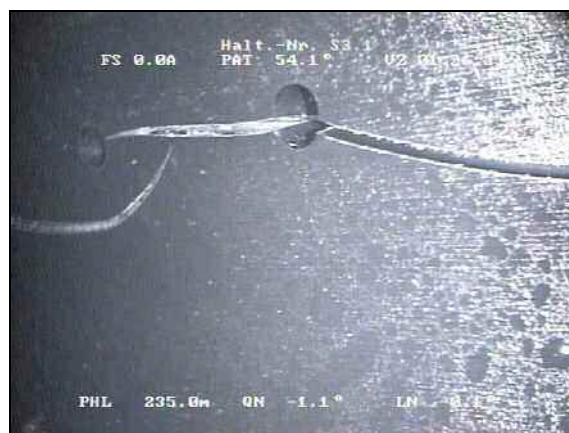
Abbildung 10 Typischer Längsrisss beginnend an einem Drainageloch
