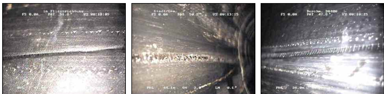
Abbildung 6 bis 8 Entwicklungsstadien der Rissbildung in biegesteifen Rohren
