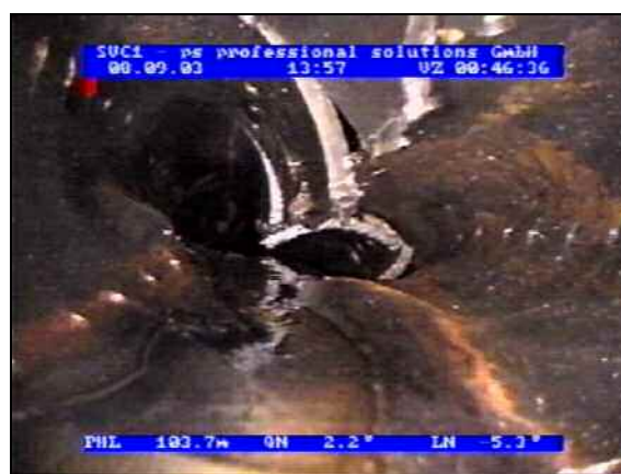
Abbildung 12 Einsturz einer gelochten PE-Leitung
