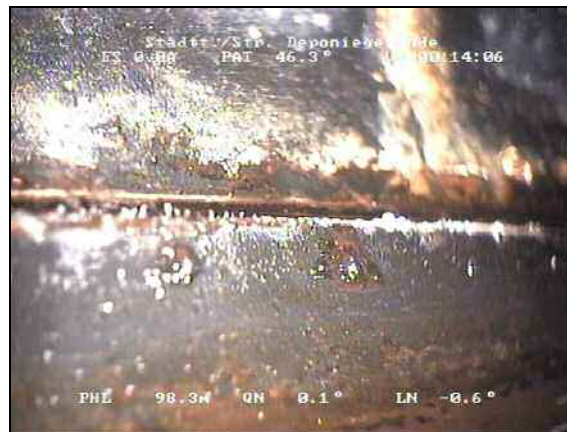
Abbildung 11 Riss in der Rohrsohle einer PE- Leitung
