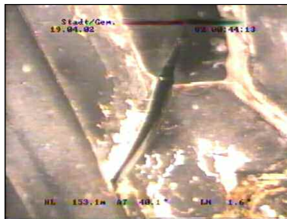
Abbildung 9 Riss ausgehend von einem Schlitz
